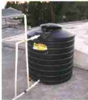
خزان مياه شكل (١٦)
